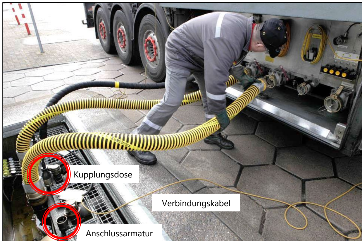
Abbildung 1: Tankbefüllung vom Tankwagen
